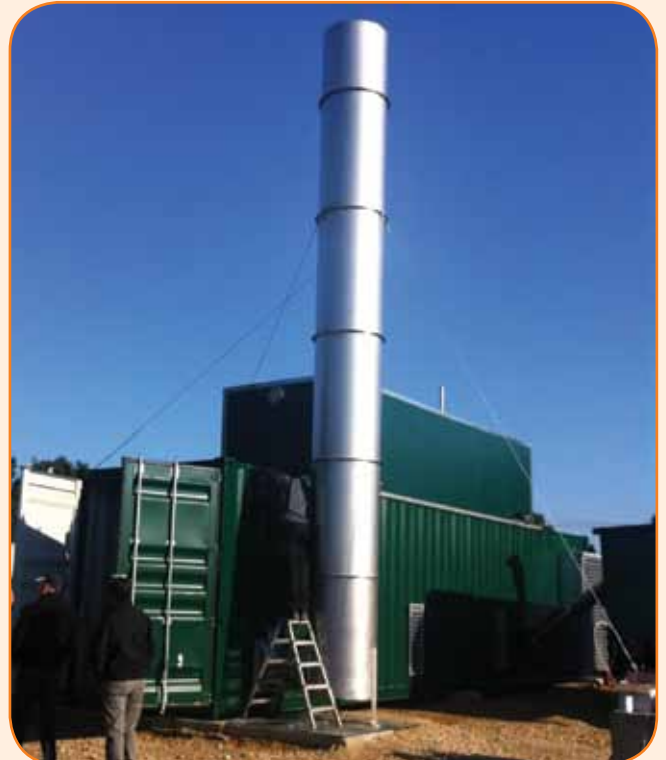
מתקן ייבוש ואיזו מי התסנין (מי הנטל) הצמוד למתקן הביוגז
